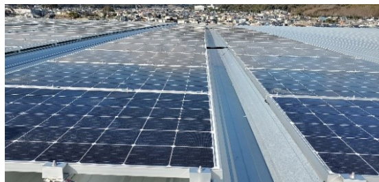
屋上に設置した太陽光パネル
