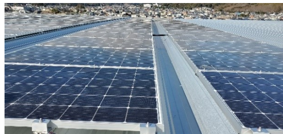
屋上に設置した太陽光発電パネル
